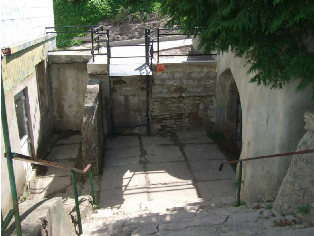
Рисунок Д.2.3 – Загальний вигляд вхідної групи в підвал будівлі учбового корпусу №1. Горизонтальна площадка перед входом в підвал будівлі учбового корпусу №1
