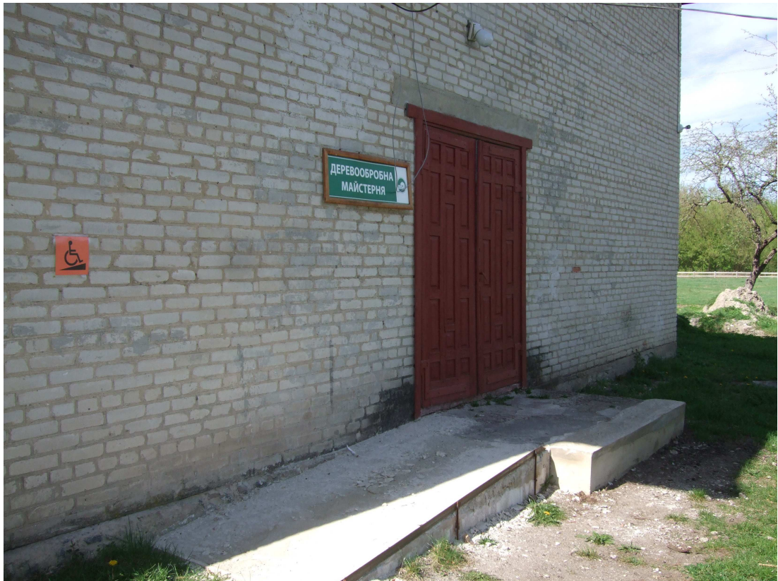
Рисунок Д.2.3 – Загальний вигляд вхідної групи та пандусу до будівлі деревообробної майстерні. Горизонтальна площадка перед входом до будівлі деревообробної майстерні
